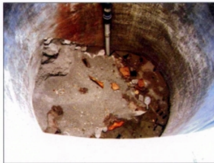
Foto 10. Pelulukan yang menyebabkan sumur penduduk dengan kedalaman 13 m kering dan penuh terisi pasir dari bawah. Lokasi : Dusun Kotesan, Prambanan (ST 42).
