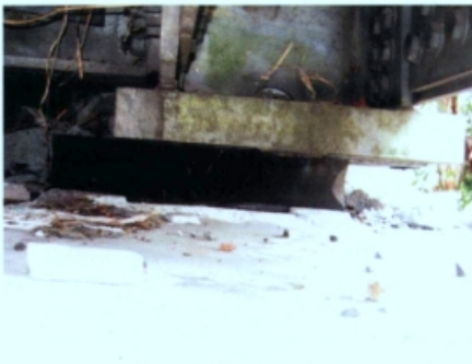
Foto 3. Dudukan jembatan bagian barat bergeser ke utara 10 cm. Lokasi jembatan Sungai Opak, Kecamatan Pleret (ST 65).
