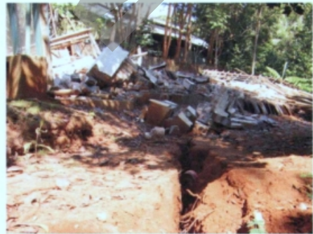
Foto 6. Rekahan tanah berarah N50°E lebar 10-30 cm masuk ke rumah penduduk hingga hancur rata dengan tanah. Lokasi Dusun Ngoro-oro (ST 14).
