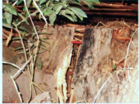
Foto 4. Tonggak kayu jati terbelah selebar 12 cm. Lokasi pinggir Sungai Gawe (Dusun Berjo) ST 27.
