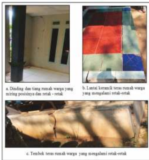
Gambar 7. Kondisi rumah warga yang mengalami retak-retak akibat adanya gerakan tanah yang masih aktif di lokasi penelitian.
