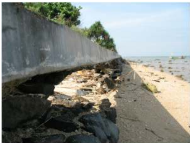
Gambar 7. Tanggul/dyke yang dibangun sepanjang pantai untuk mencegah laju erosi pantai (abrasi), mengalami kerusakan dan apabila hal tersebut tidak segera diperbaiki akan mengakibatkan kerusakan yang lebih parah
